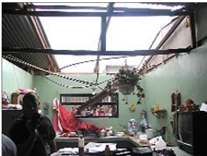
Foto 1: Un tornado afectó en Cartago
